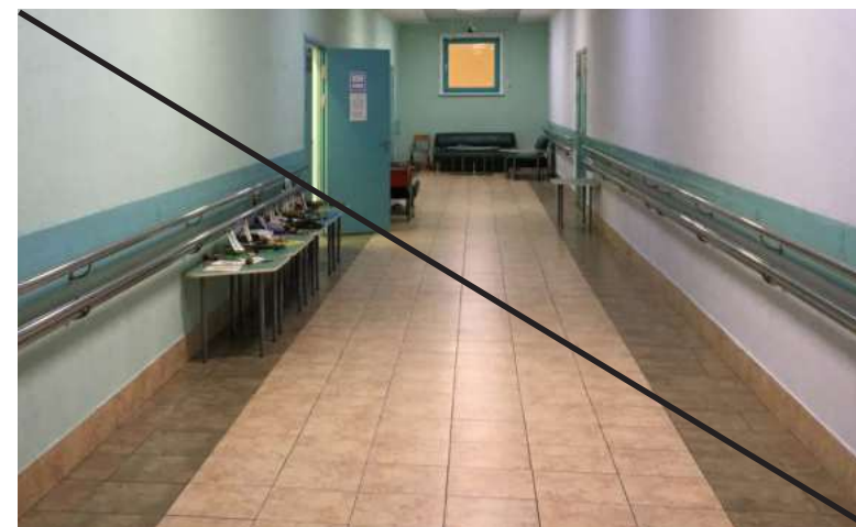
Плохо Керамогранитная плитка с крупными швами
