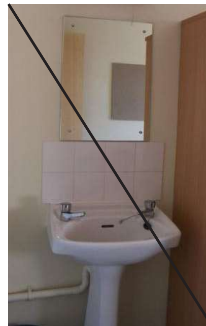
Плохо Раковина с пьедесталом. Фартук из плитки
