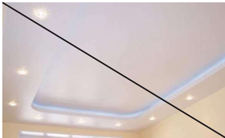
Плохо Многоуровневые гипсокартонные конструкции
