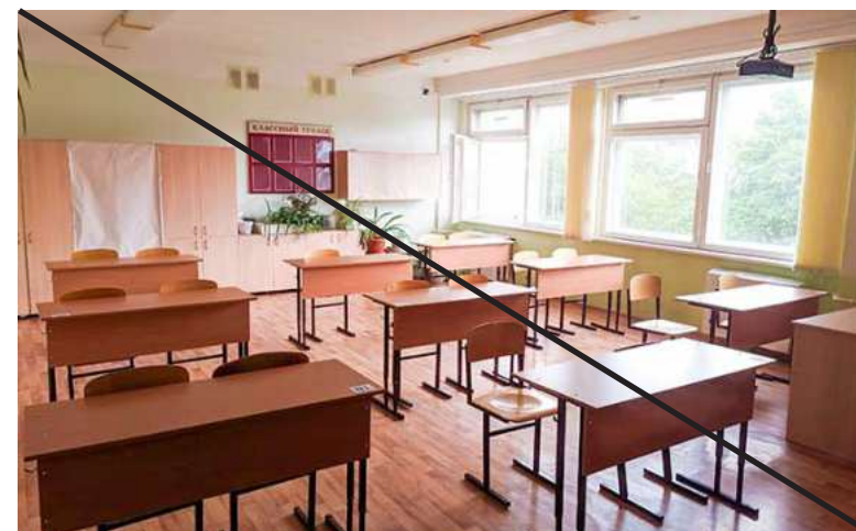
Плохо Линолеум под дерево
